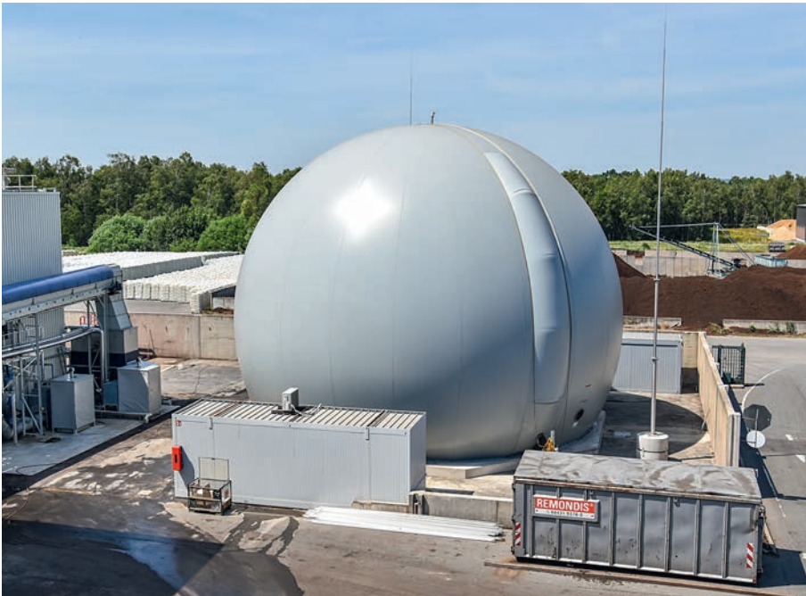
In diesem Gasspeicher sammelt sich das aus Bioabfall erzeugte Biogas.
